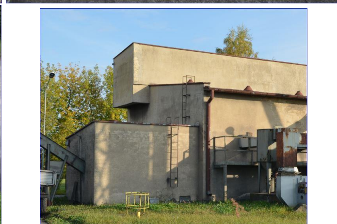
DRABINY WEJŚCIOWE NA DACHY
